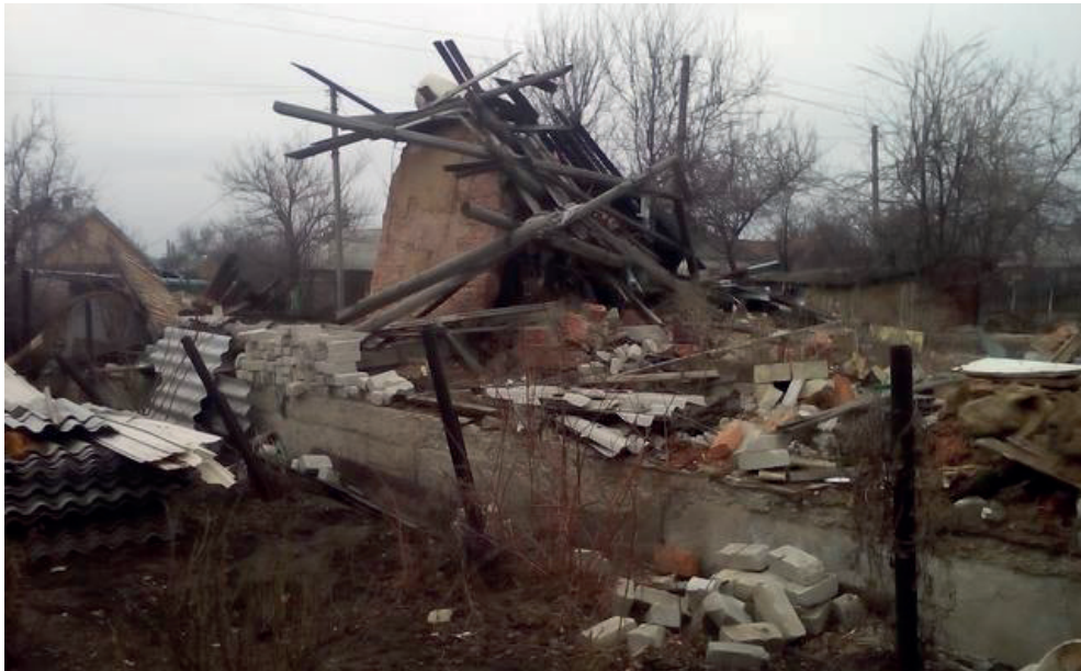
Повністю зруйнована нерухомість. Фото: Програма «Житло»/NRC
