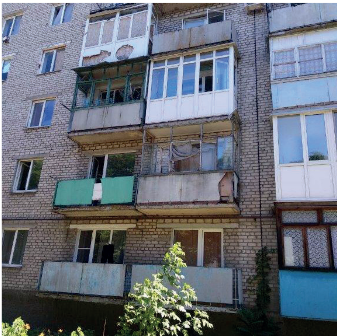
Пошкоджена багатоповерхова будівля в м. Мар'їнка, Донецька область. Фото: Програма «Житло»/NRC
