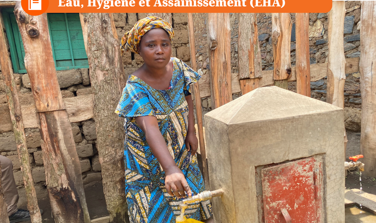
Figure 7: Utilisation d'une borne fontaine par une habitante au Nord-Kivu/NRC
